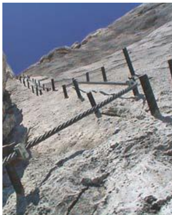
Slika 52: stopni klini predstavljajo povečano nevarnost poškodb
